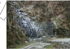
Fig 10 - Vista della barriera installata lungo la zona di scorrimento della valanga Rio Colombari
